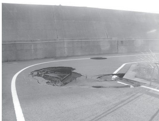
写真-事例 5.1 港湾施設での陥没
