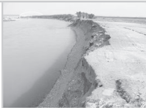
写真-事例 6.4 河岸の洗掘例
