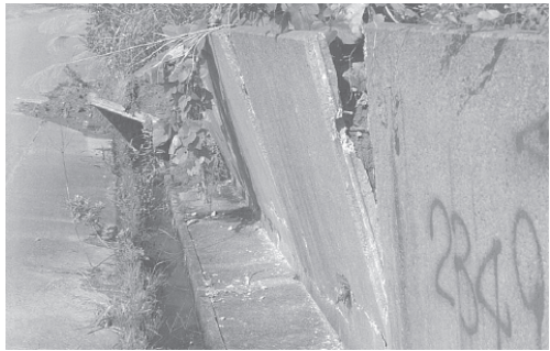
写真-3.1.1.1 被災状況
