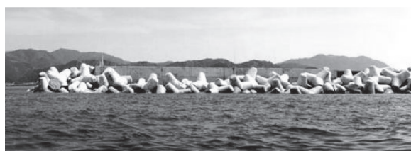
写真-事例 6.5 消波ブロックの沈下
