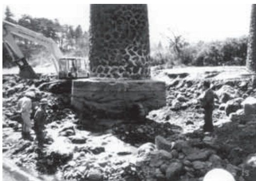
写真-事例 6.3 橋脚の洗掘例
