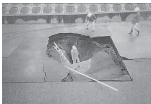
写真-2.1 陥没状況の例 3)
