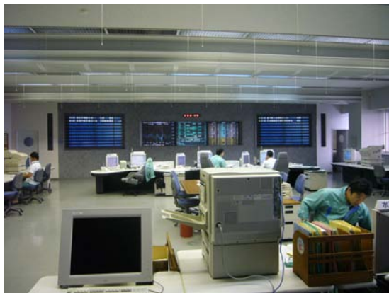
写真 A2-3 浄水場の監視操作室
