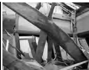
能登半島地震(2007年3月)による県指定文化財建造物の被害(輪島市角海家)
