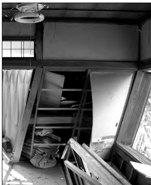
写真8 中越地震における被害例－2（柱の折損）
