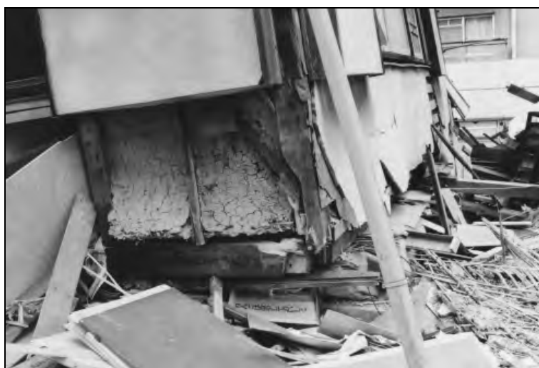
写真4 写真3の建物詳細（通し柱の折損）
