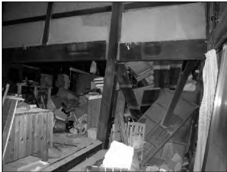
写真1 中越沖地震における被害例
