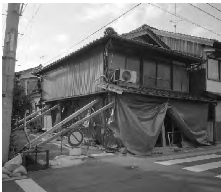
写真6 鳥取地震における被害例（店舗併用住宅）
