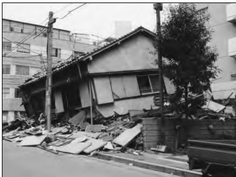
写真3 兵庫県南部地震における被害例ー1（集合住宅）
