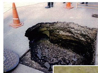
下水管の腐食による道路陥没
